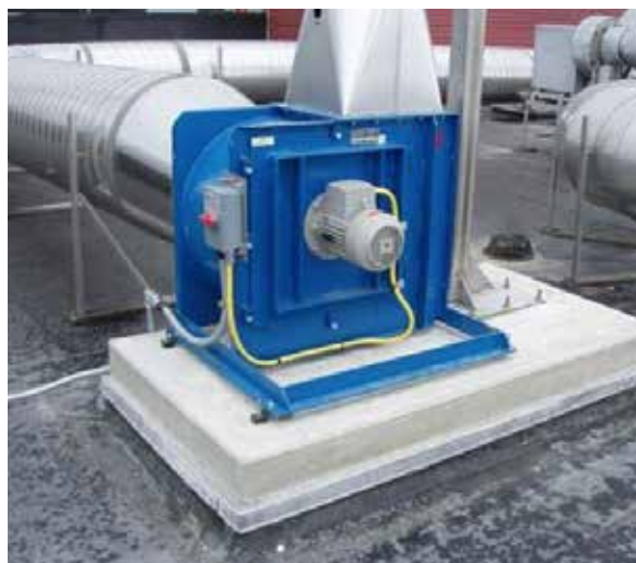
Вентилятор размещен на крыше.
