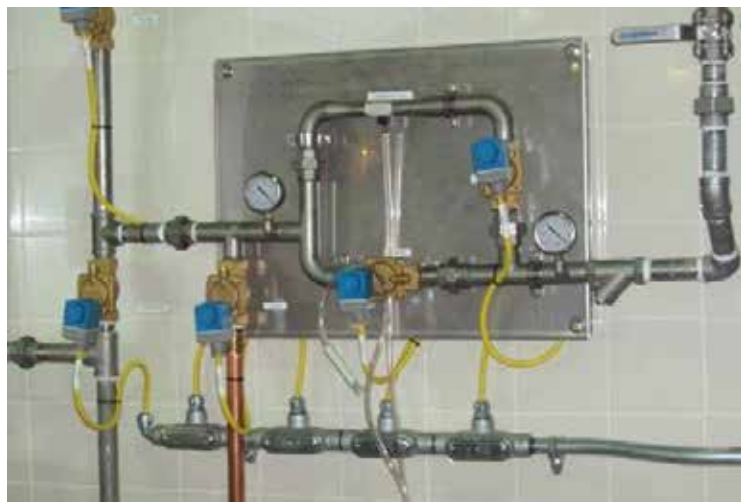
Автоматическая система очистки.
